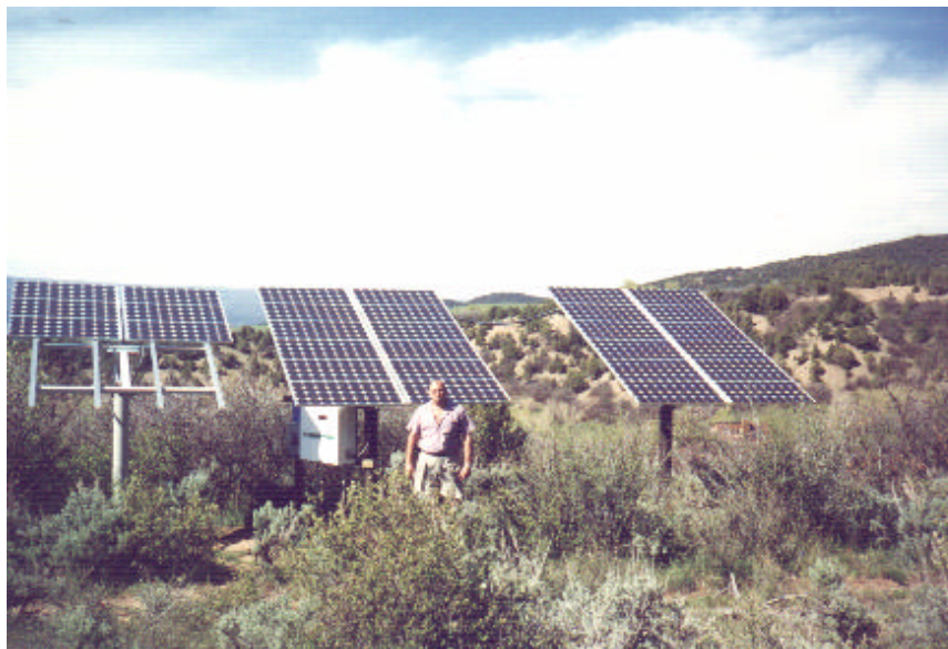
En la foto se puede apreciar tres paneles con módulos fotovoltaicos
